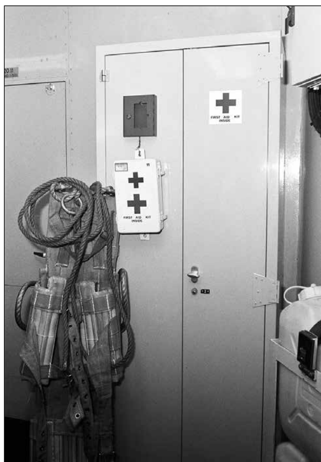
Afb. 15: Eerstehulpkast aan boord van S-fregatten. Op de deur ter illustratie de verbandtrommel V13. Tegen de kast een Neil Robertson brancard.
